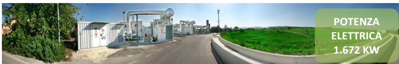
Figura 7 – Vista dell'impianto di recupero energetico
